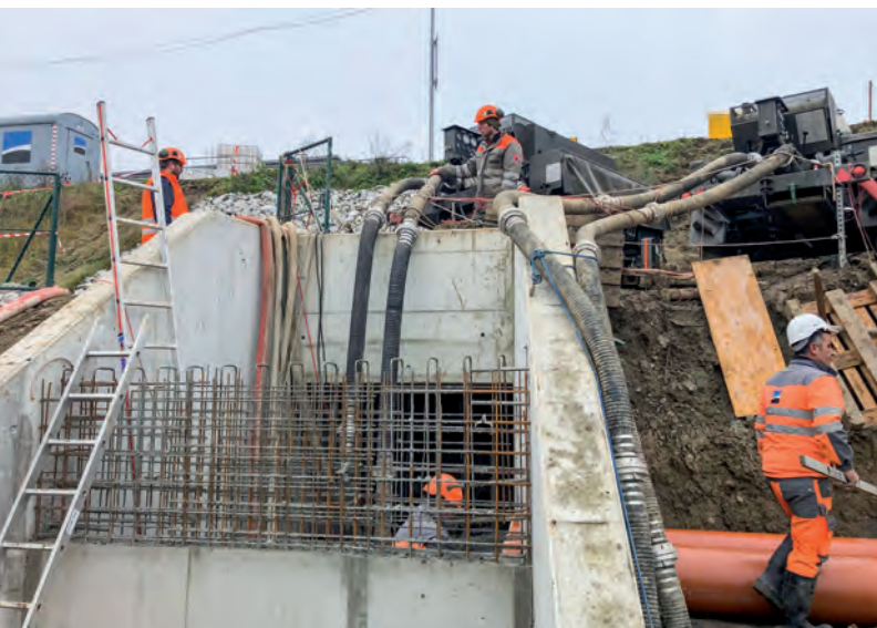
L'INTERVENTION DE NOVEMBRE 2019, LORSQUE 45 000 LITRES DE DIESEL S'ÉTAIENT ÉCOULÉS DANS LE BASSIN DE RÉTENTION ET DEUX RUISSEaux.
