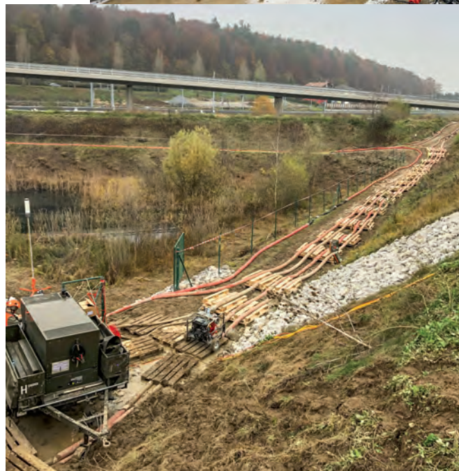
BILDER VOM EINSATZ IM NOVEMBER 2019, ALS IM FREIBURGISCHEN GIVISIEZ RUND 45'000 LITER DIESEL IN DAS RETENTIONSBECKEN UND IN ZWEI BÄCHE FLOSSEN.
