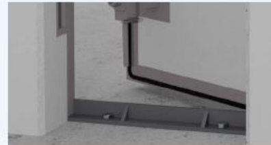
Abb. 5a/5b Für eine bessere Zugänglichkeit im Alltag wurden manche Schutzräume ohne Schwelle erstellt. Sie verfügen über eine mobile Schwelle, etwa an der Panzertüre befestigt, die beim Vorbereiten am Boden festgeschraubt wird.
