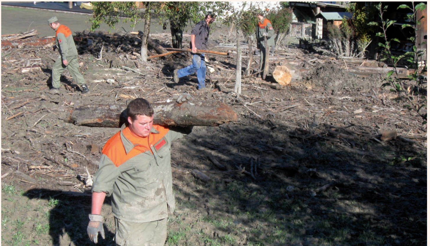
TRAVAUX DE DÉBLAIEMENT APRÈS LA CRUE QUI A FRAPPÉ LA COMMUNE DE FRUTIGEN.
