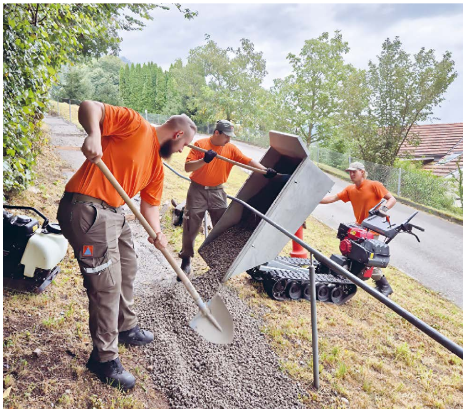
Der Fachbereich Technische Hilfe leistete unter anderem Arbeiten für die Instandhaltung von Wanderwegen.
